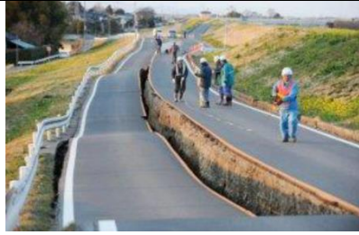
Document 1 : Photographie d'une route fracturée suite au séisme du 11 mars 2011 au Japon
